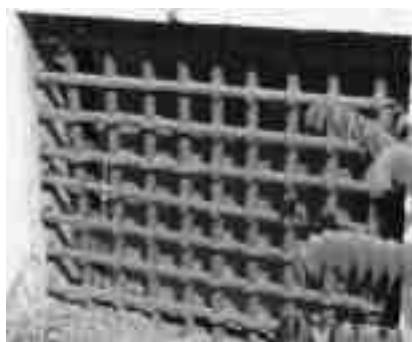
Robusta inferriata di una finestra del piano seminterrato della palazzina ex Monte di pietà sul Cornalé, a difesa dei pegni depositati
